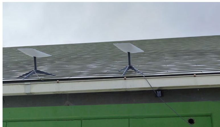
Antennes Starlink sur le toit du Parlement de Kiribati. © UIP/CIP
