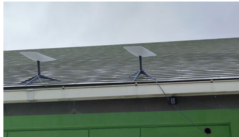
Antenas Starlink en el tejado del Parlamento de Kiribati. © UIP/CIP
