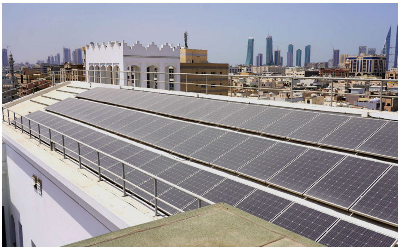
Panneaux solaires sur le toit du Conseil des représentants de Bahreïn. © Parlement de Bahreïn
